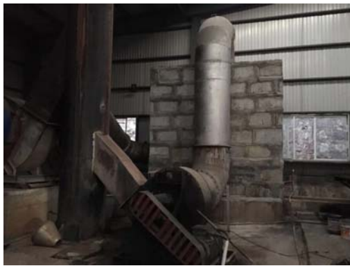
水膜脱硫除尘系统
