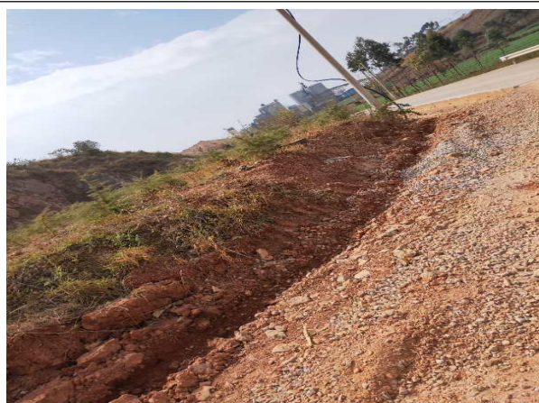
雨水收集沟渠
